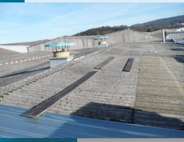
Toitures et ardoises en fibrociment
