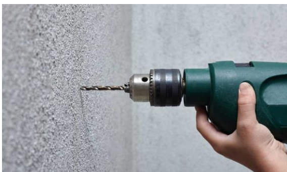
Percement d'un mur avec un enduit du plâtre ou une peinture amiantée
