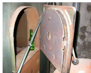
Tresse sur porte de chaudière
